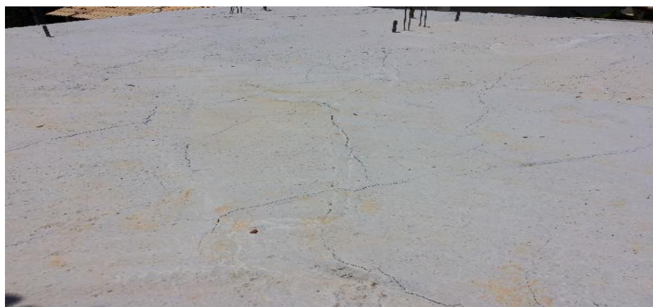
Figura 1 – Estado de fissuramento da superfície da laje.
