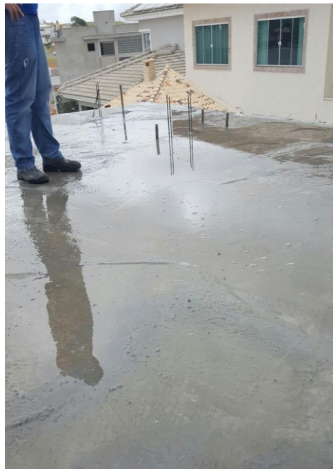
Figura 10 – Saturação da superfície da laje.
